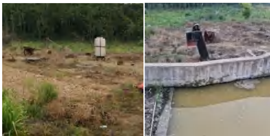
图 2-11 现有污水处理设施现场照片
