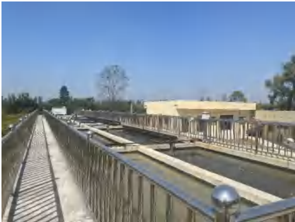
AAO池、絮凝沉淀池
